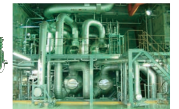
プラント配管
