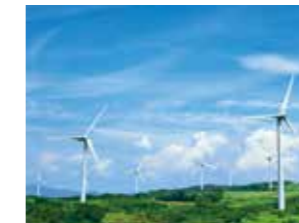
風力発電システム
