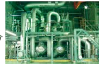
プラント配管
